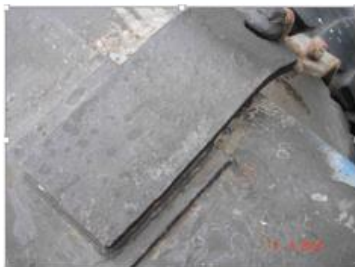
Vista de soporte después de 26 días de aplicación del producto
