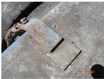
Soporte de defensa en muelle antes de tratamiento
